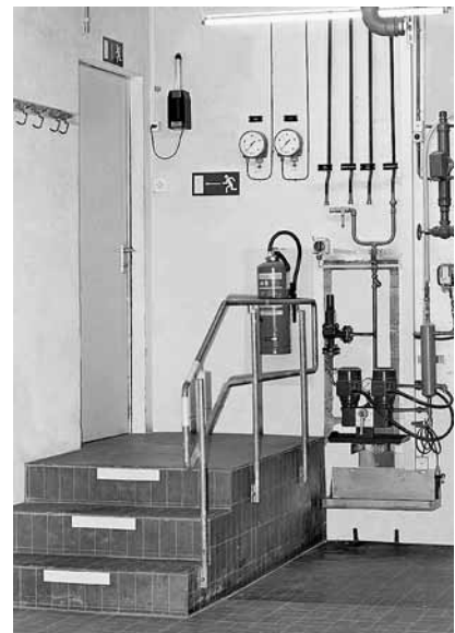
Figura 4: via di fuga segnalata da strisce fotoluminescenti (luce diurna).
