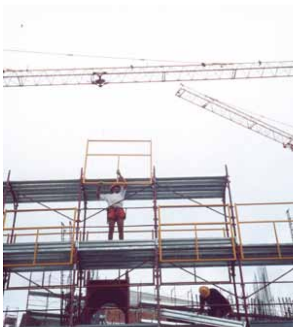
Foto 2. Montaggio del ponteggio a telai prefabbricati in sicurezza con parapetto provvisorio dal di sotto.
